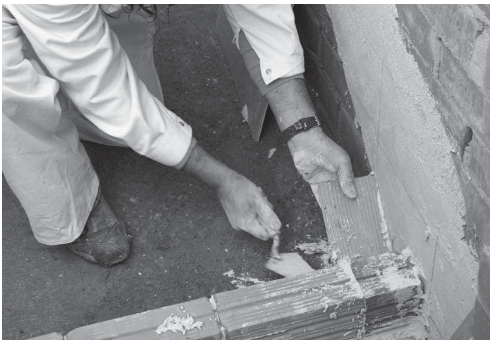
Lámina 7. Untado y colocación de las primeras rasillas contra la zapata de arranque.
