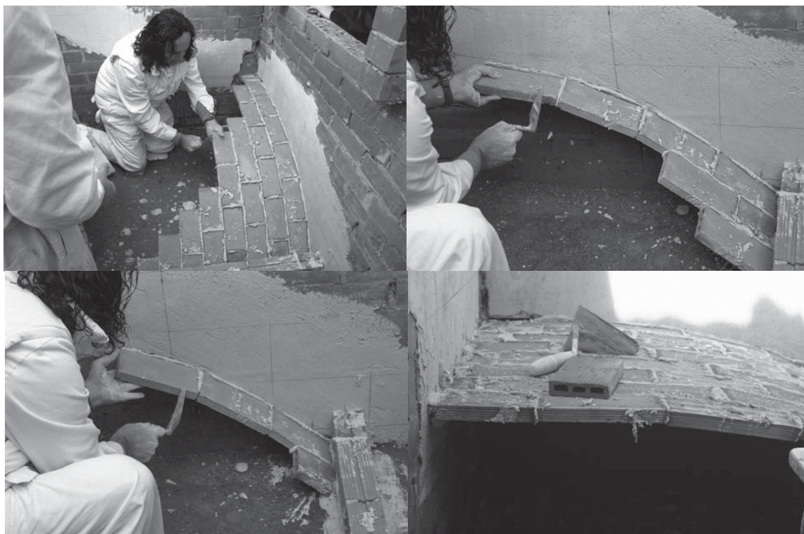
Láms. 8 a 11. Colocación de rasillas de la primera rosca. El oficial coloca cada rasilla a sentimiento, siendo consciente en todo momento de la forma definitiva que debe tener el tablero..
