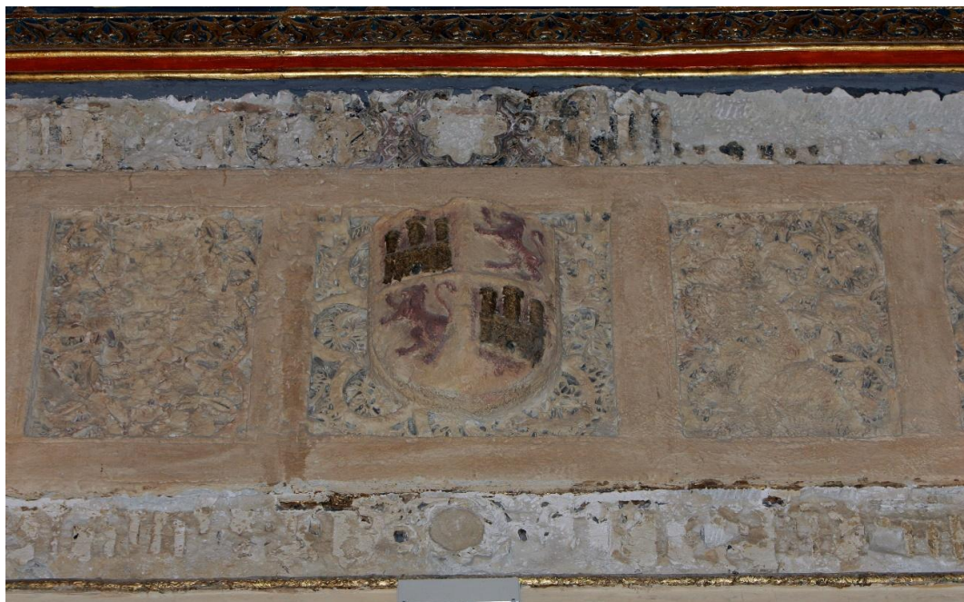
Figura 9: Estado del friso durante la intervención de 2008. Foto: Ana Lourdes Blanco.
